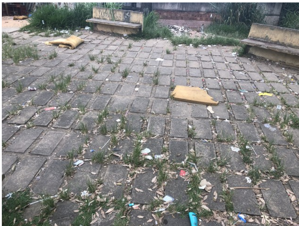
Invasão de vegetação, acúmulo de lixo e entulho
