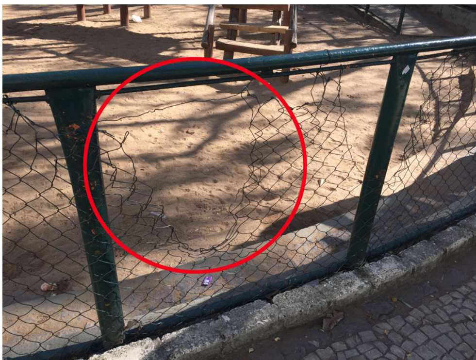
Grade de proteção do parquinho necessita de reparos
