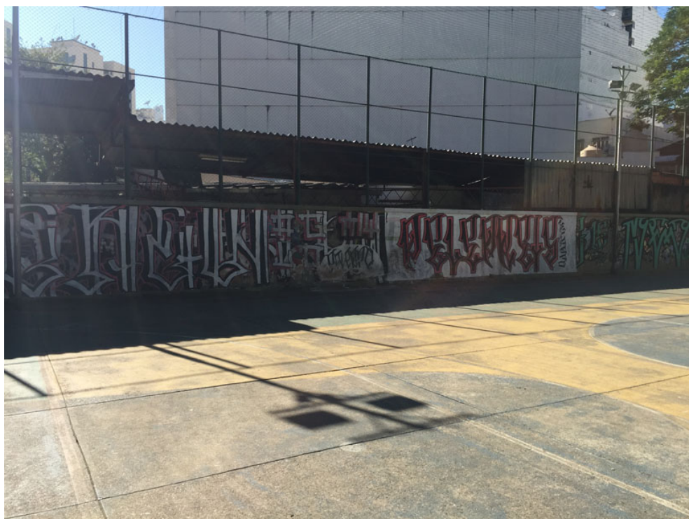
Necessidade de pintura de forma geral
