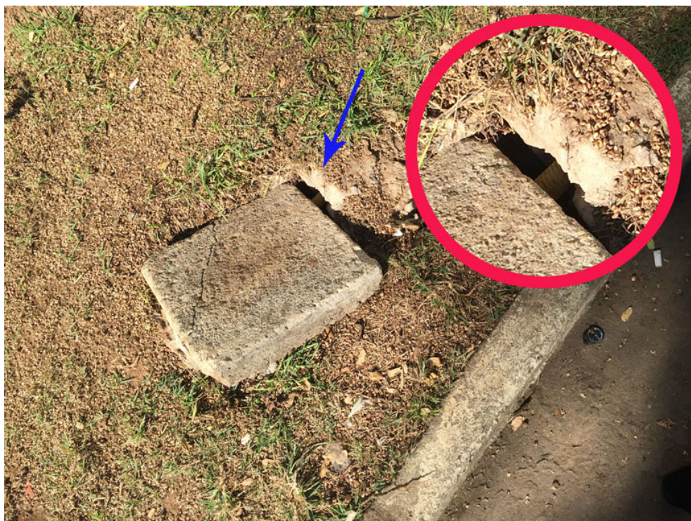
Caixas de passagem (energia elétrica) sem fechamento.
