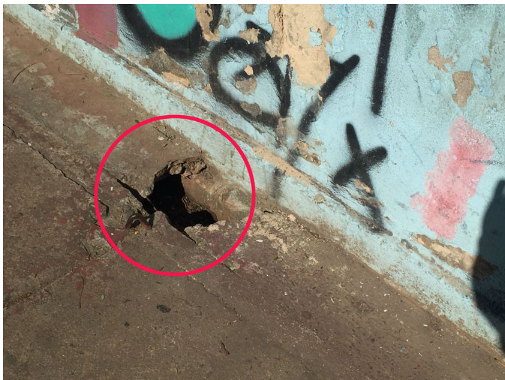
Área de drenagem necessidade de reparos
