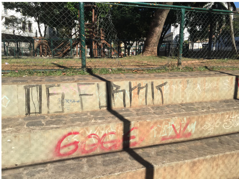
Grade de proteção necessita de reparos
