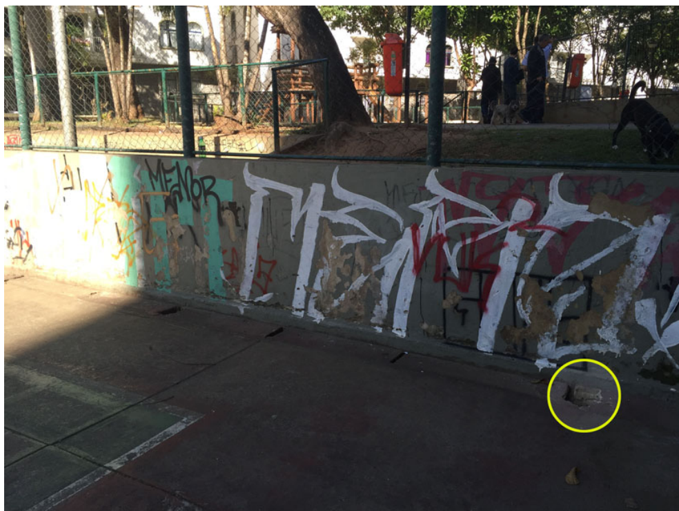
Necessidade de pintura e reparos na área de drenagem
