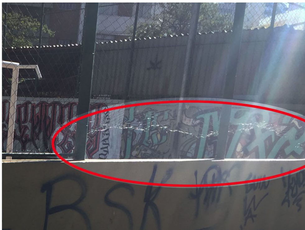
Grade de proteção da quadra necessita de reparos
