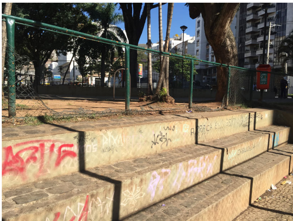
Grade de proteção necessita de reparos
