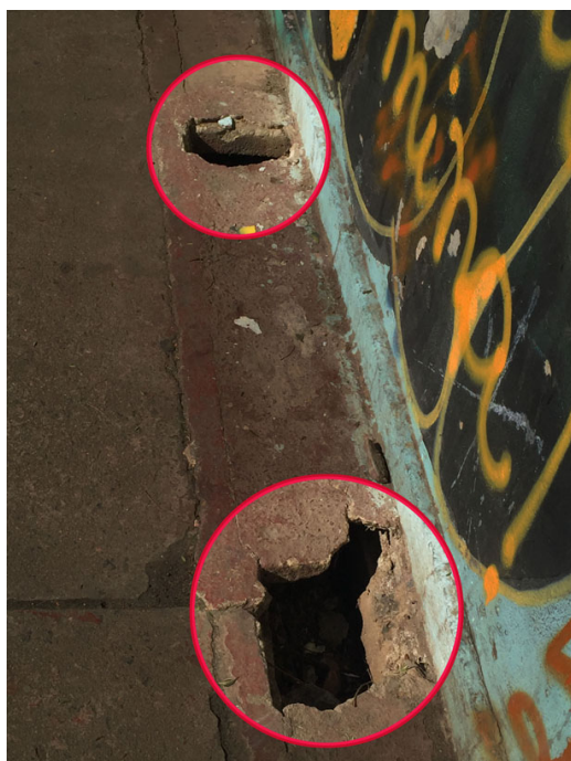
Área de drenagem necessidade de reparos
